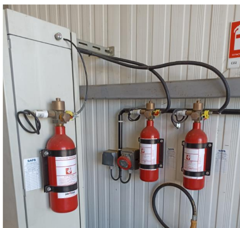
Figure 9 : Extinction automatique armoire process bâtiment 2
