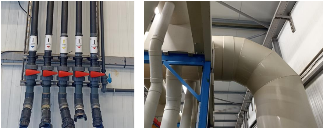
Figure 13 : Bâtiment 2, canalisations récupération produits + Canalisation récupération air de l'atelier
