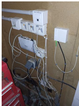
Figure 8 : Arrivée télécom et fibre optique bâtiment 1
